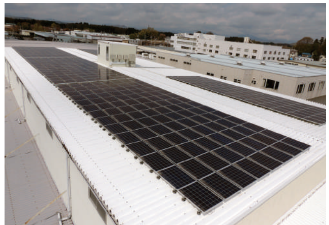
▲ 太陽光発電施設(当社、鹿沼配送センター [KDC])
